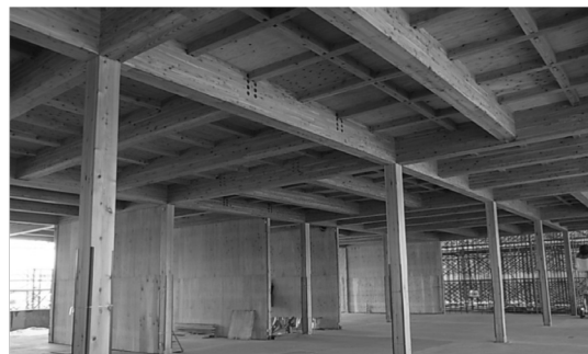
中断面集成材と住宅用梁受金物による6mグリッド2階床組+高倍率耐力壁
