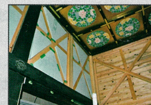
筋違とJパネルによる耐震壁
