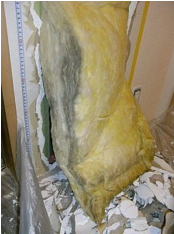
黒く変色した断熱材
