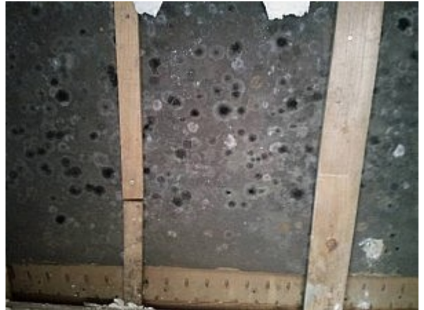
鬼怒川決壊で浸水してから2ヵ月後の室内の壁の一部。壁の内側がカビていた。
