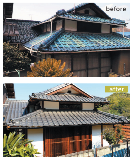
南外観 セメント瓦を和瓦に葺き直し外壁を漆喰で塗りアルミサッシを木製格子戸で覆った。
